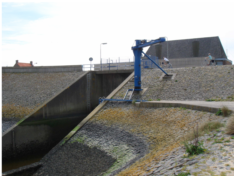
Figuur 3-1: Gemaal bij Cadzand-Bad
