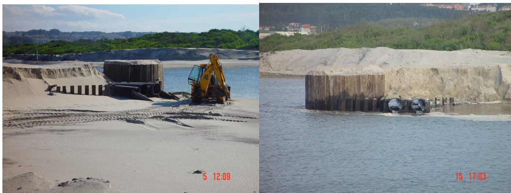
Fig. 6 Locais de maior fragilidade da obra, na zona de transição ente o encontro em madeira e o dique de areia e para onde se propõe a colocação de geotextil para combater tal fragilidade. (Fotos de António Mota Lopes)
